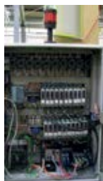
L'armoire électrique abrite le conditionnement des signaux et un contrôleur cRIO-9068.
