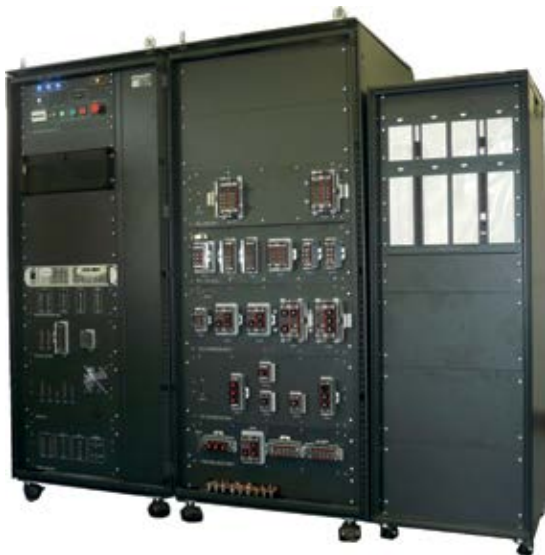
Banc de tests PEPDS (signaux, puissance, coupures).
